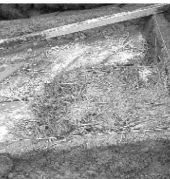
Paja mezclada con cal para aislamiento en cubierta.
